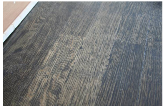
Lattiaa ei ole kitattu. Kuvassa ylösvuotoa parkettisauvojen saumoista. Ongelmana ulkonäkö ja huono tartunta.
